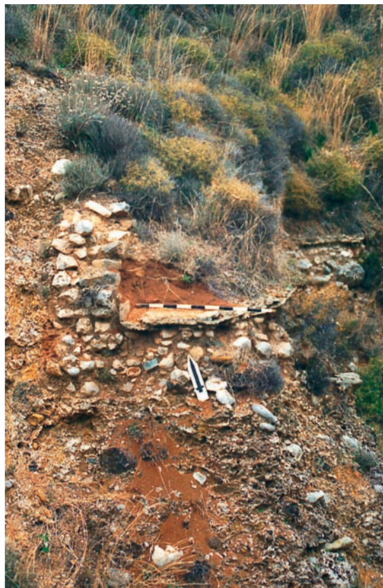
Ο αγωγός στις όχθες του ρέματος της Αναπνογάς. Η δεξιά του πλευρά έχει καταρρεύσει.
